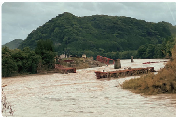
球磨川鉄橋の崩落
